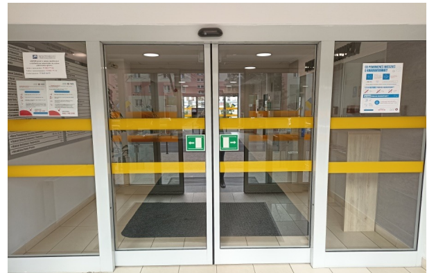
Drzwi wejściowe do budynku Starostwa
