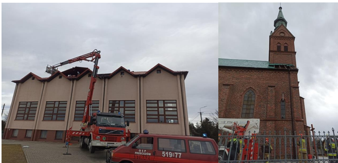
Zdjęcia 02.2023 r. Działania ratownicze przy uszkodzonych budynkach
