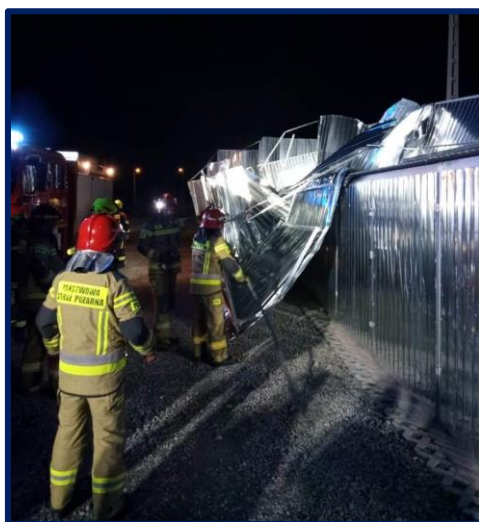
Zdjęcie – archiwum KP PSP w Oświęcimiu - styczeń 2023 r. uszkodzone garaże Kęty ul. Żwirki i Wigury
