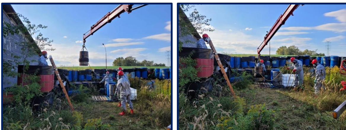
Zdjęcia – archiwum KP PSP w Oświęcimiu – sierpień 2023 odpady niebezpieczne Spytkowice pow. wadowicki
