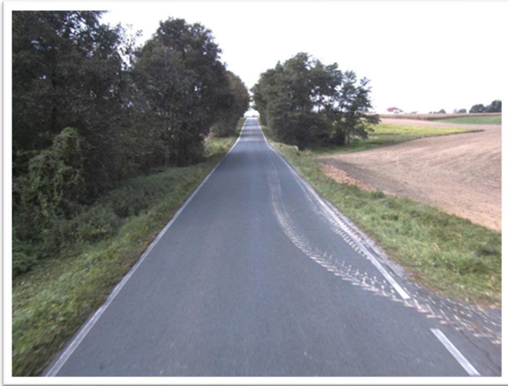
Droga przed remontem (ul. Wadowicka, Głębowice)
