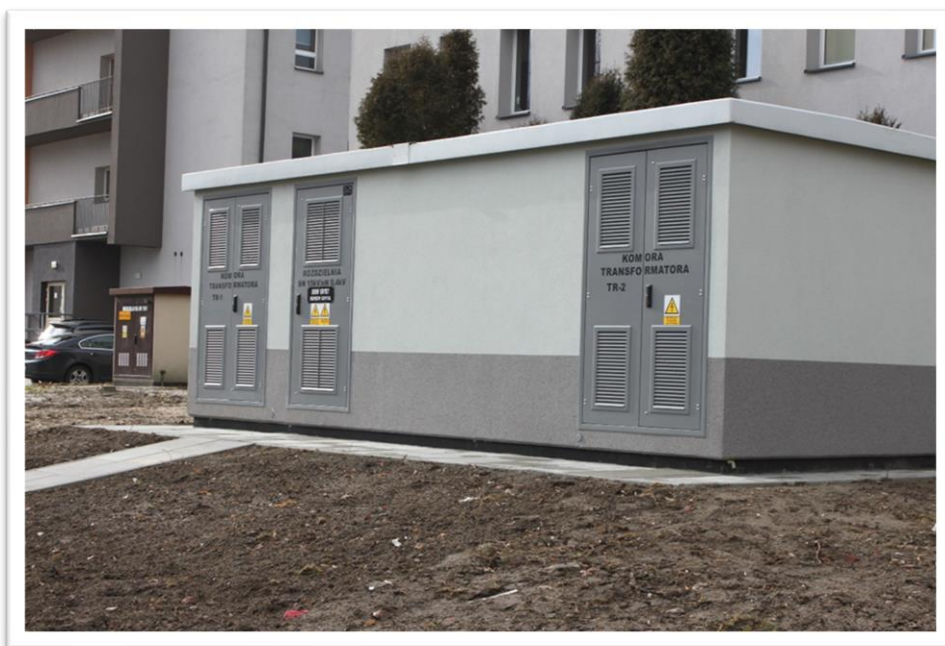
Stacja transformatorowa przy ZOZ
