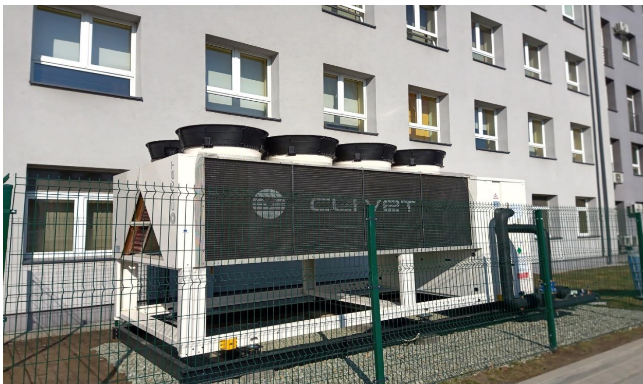
Agregat wody lodowej
