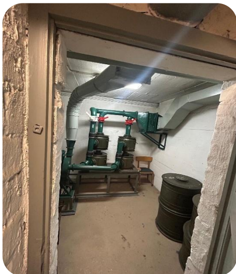
System filtrów wentylacyjnych schronu
